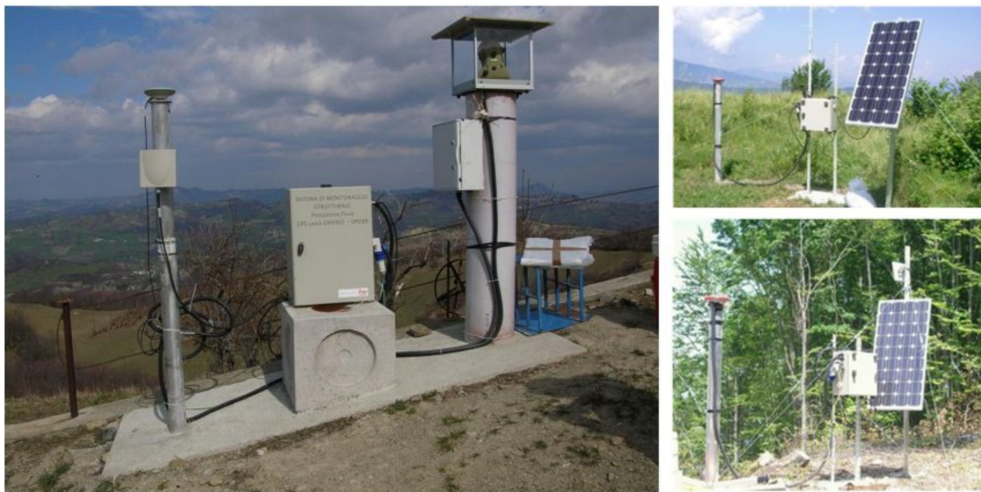
Figura 1. Frana di Valoria (MO): postazione master del sistema di monitoraggio continuo e materializzazione dei GPS rover in frana.
